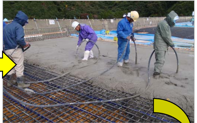
② 床版コンクリートを流し込みバイブレータ (振動機)を用いて締固めを実施
